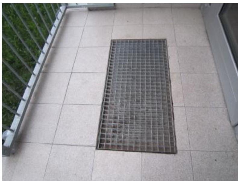
FOTO 4 : Rohože vsazené do dlažby nejsou opatřeny vodotěsnou vaničkou a nejsou odvodněny mimo podestu (vstup 523/7 do ulice).
