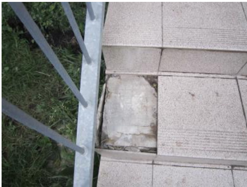
FOTO 5 : Odpadlá dlaždice – pod dlaždicí je patrná velká tloušťka lepidla, které nahrazuje únosný podklad. Na boku schodiště jsou omítkové vrstvy separované v důsledku zatékání.
