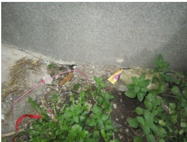
FOTO 2 : Stopy po pronikání srážek do nehtutněného zásypu u vstupu 520/1 z ulice Cafourkovy
