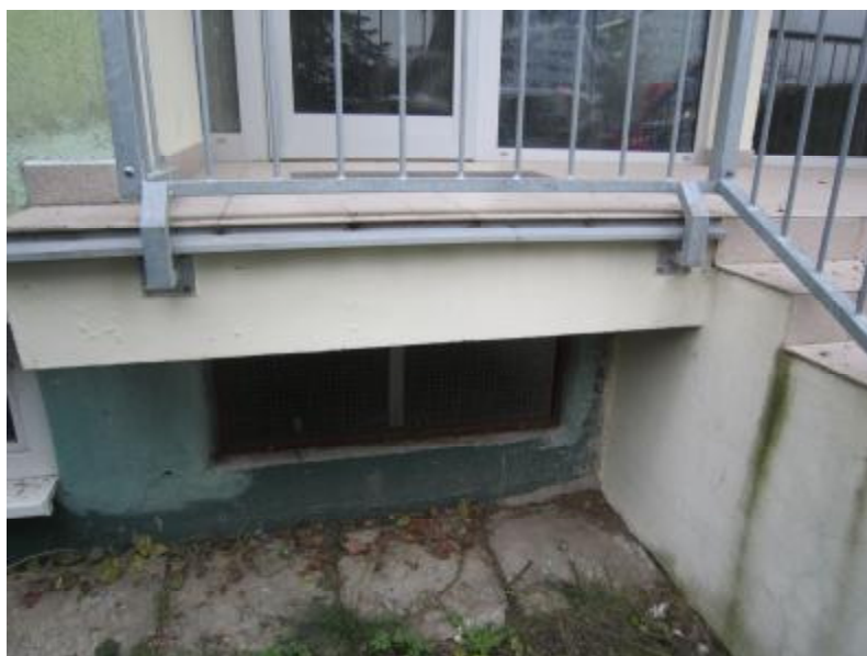
FOTO 8 : Stékání srážek ze schodů na zdivo boční zdi schodiště
