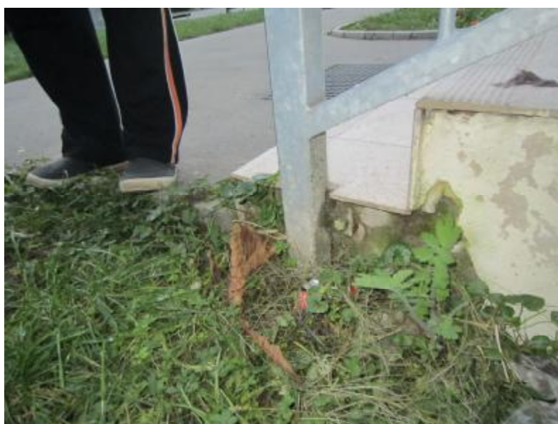
FOTO 10 : Provedení kotvení zábradlí schodů na spodním okraji schodiště podporuje zatékání a korozi detailu
