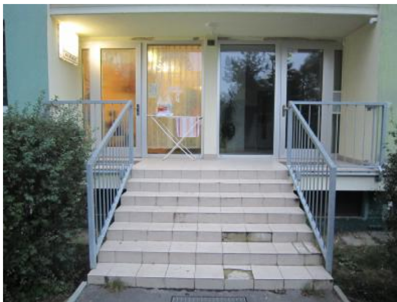
FOTO 9 : Separace obkladu na schodišti do vnitrobloku. Zábradlí schodiště nemá vůči nástupnímu stupni požadovaný přesah.
