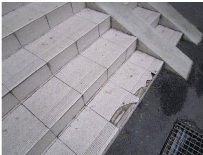
FOTO 7 : Mechanické poškození keramických dlaždic na schodech (vstup 527/9 do ulice).
