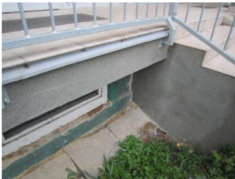
FOTO 3 : Posunutí a sklon dlaždic okapového chodníku svědčí o intenzivním sedání nehtného zásypu u vstupu 520/1 do ulice Cafourkova
